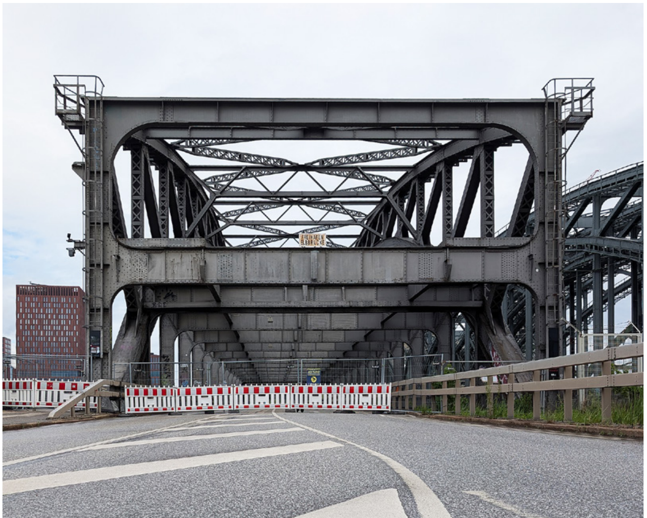
Nach dem Zusammenstoß mit einem Binnenschiff wurde die Freihafenelbbrücke komplett gesperrt.
